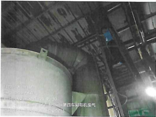
第四车间有机废气排放口 FQ-003 DA003: 总 VOCs
