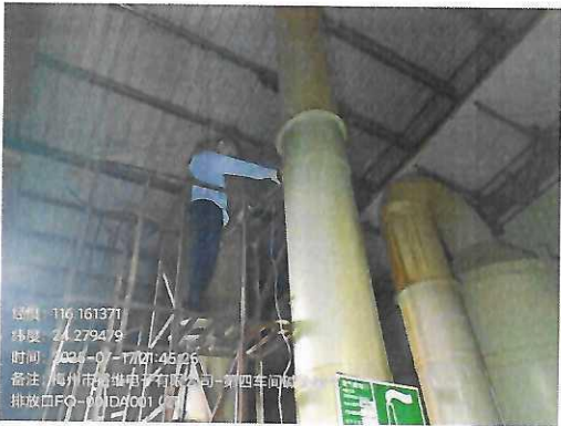
第四车间碱性废气排放口 FQ-001 DA001: 氨
