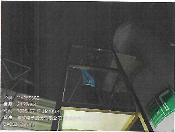
有机废气排放口 2#DA053：总 VOCs
