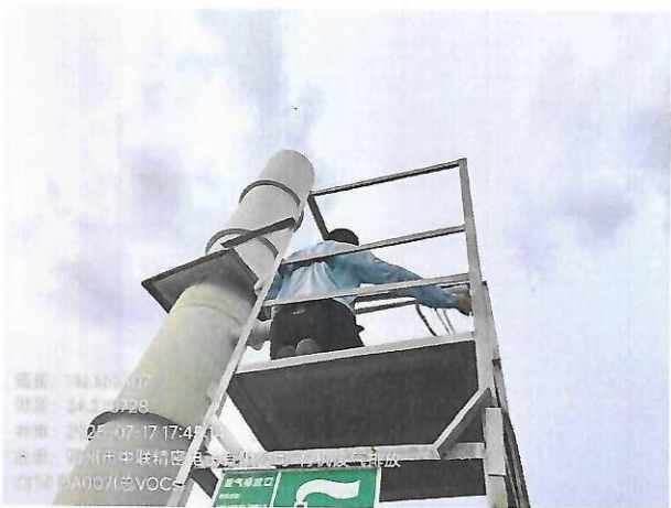
有机废气排放口 2#DA007: 总 VOCs
