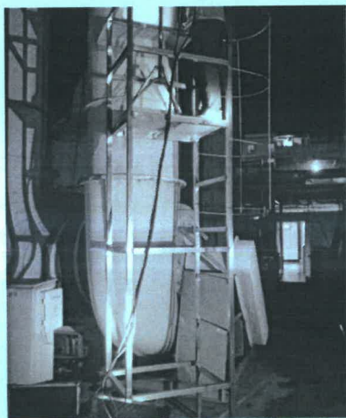
废气处理后采样口 DA037
