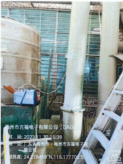
电镀车间废气排放口 DA005
