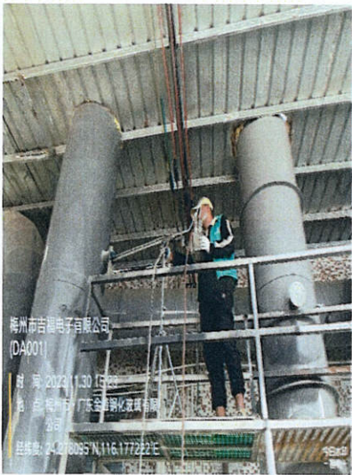
电镀车间废气排放口 DA001
