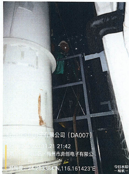
电镀 VCP 废气排放口 DA007
