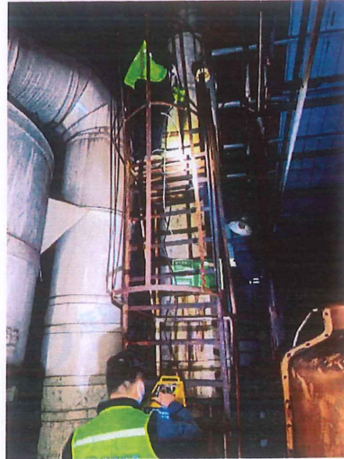
文字、阻焊、烤箱、显影工序 废气处理后排放口 DA003
