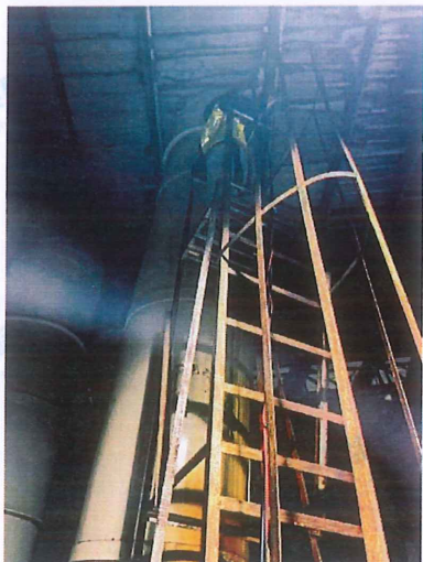
图电、沉铜、退锡废气处理后 排放口 DA002
