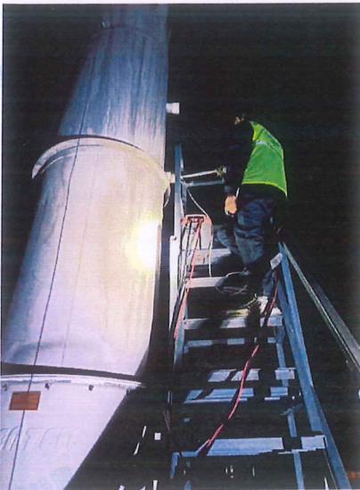
三楼沉铜线废气处理后排放口 DA013
