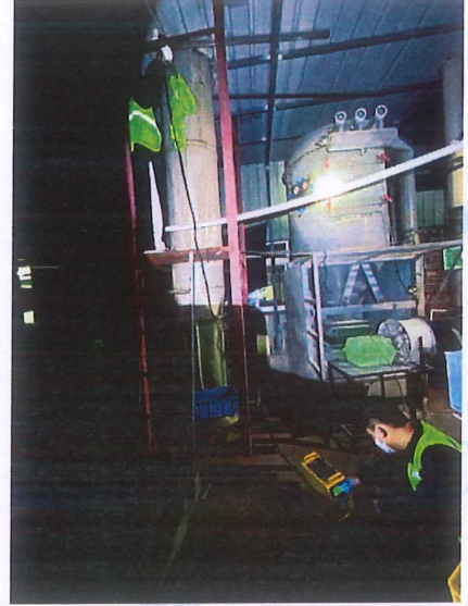
文字工序废气处理后排放口 DA006
