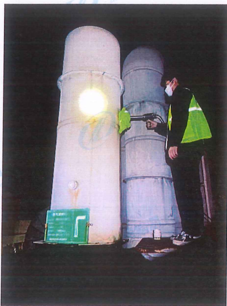
退膜、蚀刻工序废气处理后排放 口 DA002
