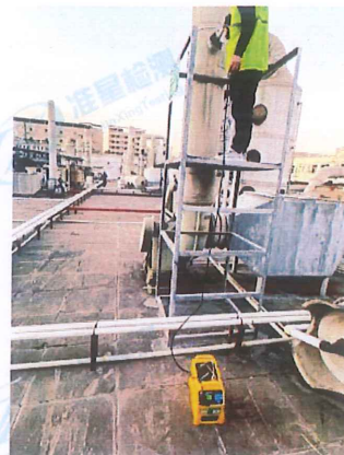
烤炉工序废气处理后排放口 DA004
