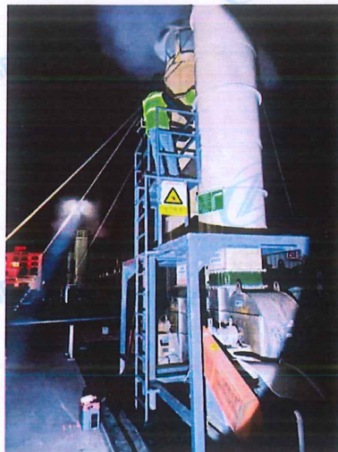
DA011生产厂房2生箔车间 废气处理后排放口
