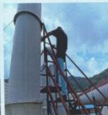
DA005 废气排放口
