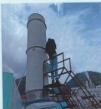
DA004 废气排放口
