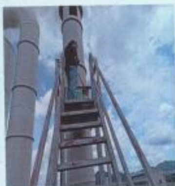
DA003 废气排放口
