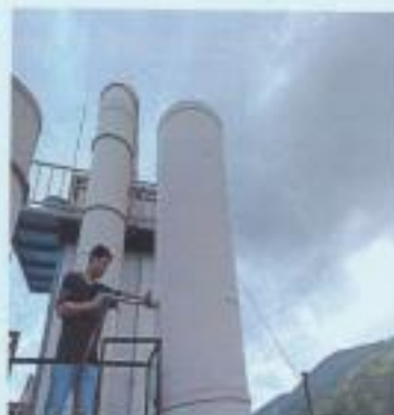
DA002 废气排放口
